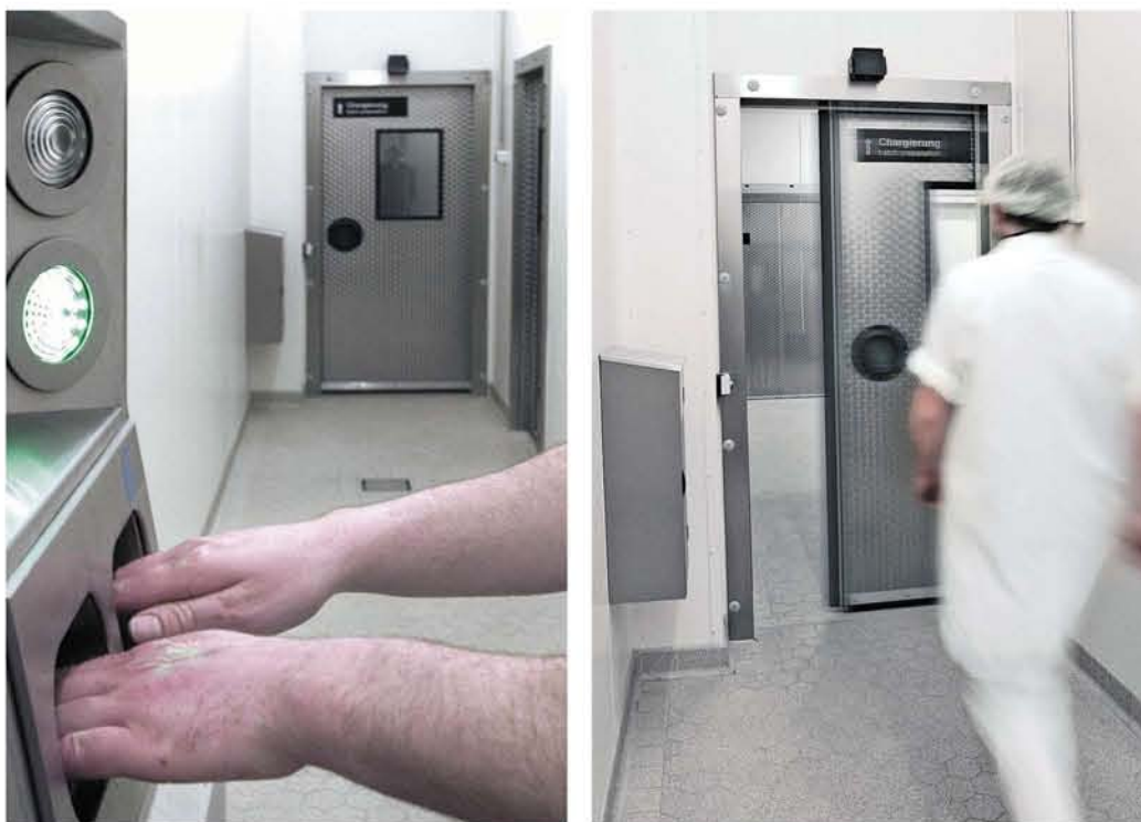
Hygieneschleuse mit automatischer Schiebetür. Die Tür öffnet und schließt berührungslos nach Benutzung der Hygieneschleuse.
