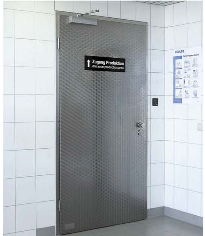
Hygiene-Brandschutztür mit elektronischer Zugangskontrolle.
